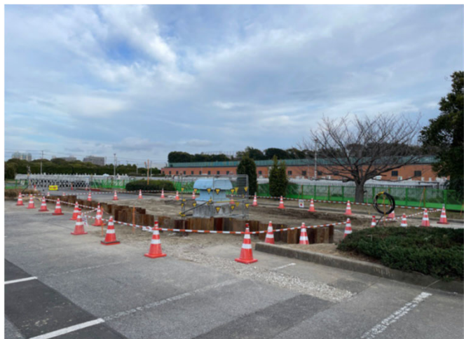
花見川終末処理場導水渠耐震補強工事 発注者：千葉県 印旛沼下水道事務所 令和6年3月完成
