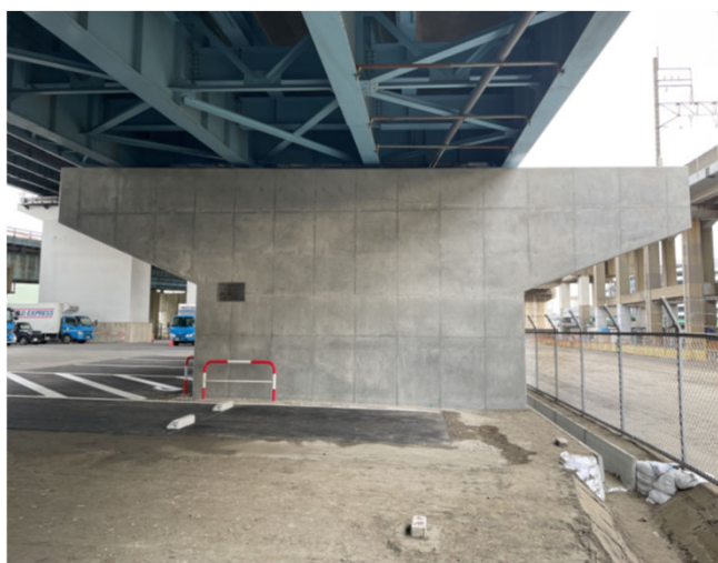
R2国道357号海老川大橋下部その2工事 発注者：国土交通省関東地方整備局 千葉国道事務所 令和4年3月完成 千葉国道事務所 優良工事受賞
